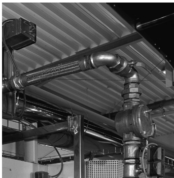
Компенсаторы на подающих трубопроводах зданий
